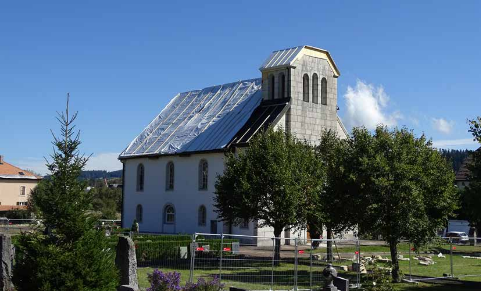
Temple des Eplatures décapité après la tempête.
